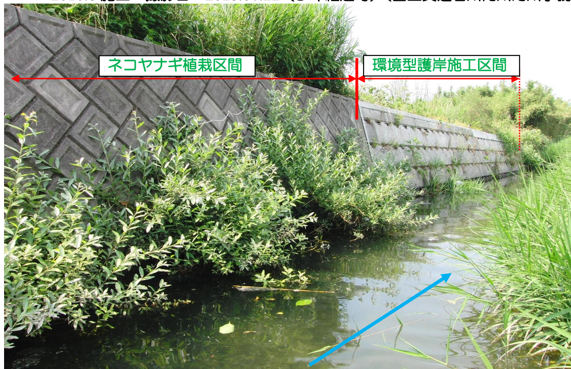
写真一No.13 二級河川二見川（八代市本町地区）左岸の試験植栽の繁茂状況 2010.2 施工 撮影日：2012.05.28（2年経過時）（熊本県八代振興局協力） 注）上流側は既設護岸へのネコヤナギ植栽区間、下流側は災害復旧による環境型緑化ブロック施工区間。エコ工法ではより早く、緑化効果が得られた。（試験施工）
