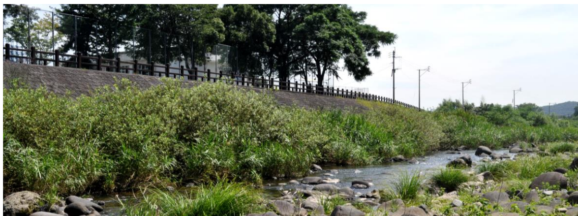
写真一No.5 二級河川岩岳川護岸における繁茂状況
